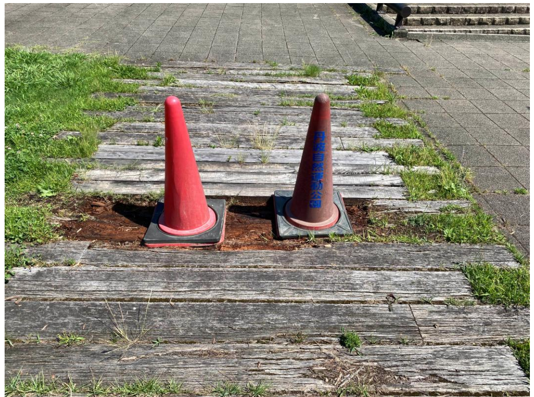
損壊した木道を示す三角コーン
