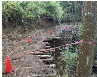
小道506 脇の崩落
