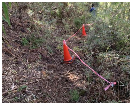
小径507 脇の崩落
