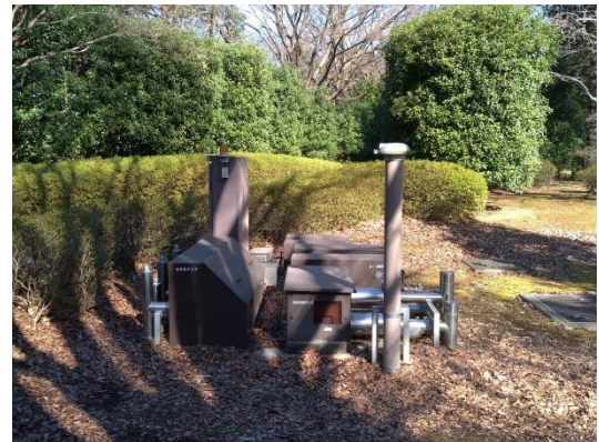
排水再利用装置制御盤
