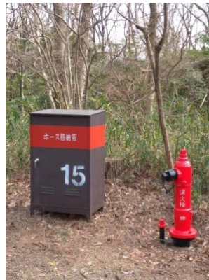
消火用ホース収納箱
