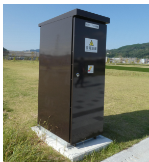
・ 変電設備（高さ 2m 以上）
