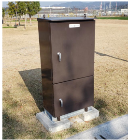
・ 小さな分電盤（高さ 2m 未満）
